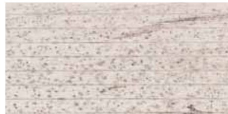
Stockflecken/Schimmel auf der Oberfläche
